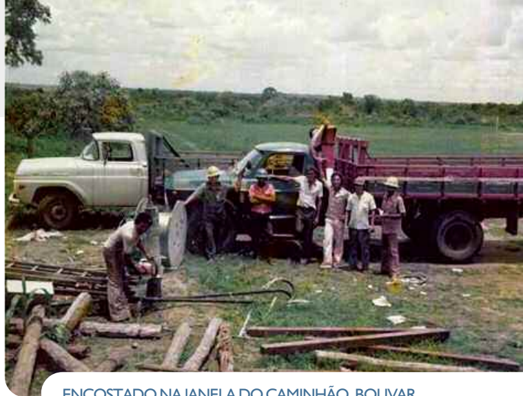
ENCOSTADO NA JANELA DO CAMINHÃO, BOLÍVAR MUNDIM E PARCEIROS, FOTOGRAFADOS POR NALDO MUNDIM, NO ANO DE 1971: CONSTRUÇÃO DA REDE ELÉTRICA NO MUNICÍPIO DE TRINDADE (GO)
